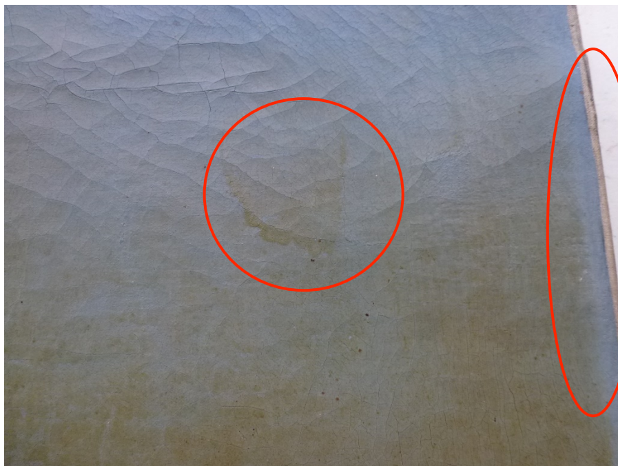
Traces de coulures, vernis oxydé excepté sur la périphérie de la surface peinte
