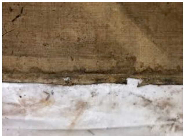
Bandes originales de cloutage défectueuses.
